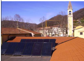
Impianto solare fotovoltaico presso piazza degli Alpini
